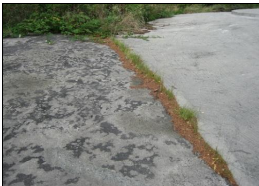
Billede 9 - Fuge/støbeskel er synligt utætte
