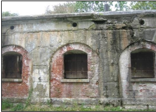
Billede 8 - Gesims/tagrendekant ødelagt og puds alvorligt nedbrud
