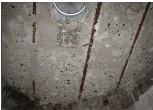
Billede 15 - Blotlagte stålprofiler/armering på underside dæk i kanontårnets nyere overdækning
