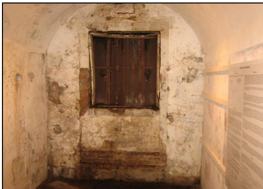
Billede13 - Tegn på fugt i facade
